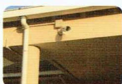
夢の森玄関に1台、夢ホーム玄関を含め3台、防犯カメラを設置しました。
